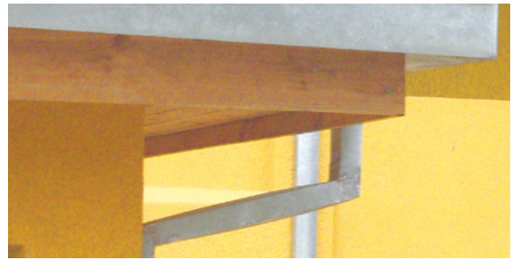
Canaletas de acero galvanizado
